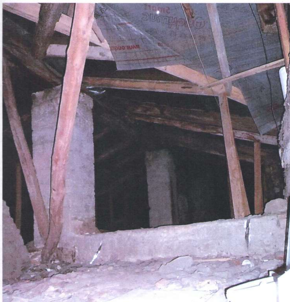
Фото 23-25. Объект культурного наследия регионального значения «Жилой дом», середина XIX века, Ставропольский край, г. Ставрополь, пр. К. Маркса, 67. Состояние крыши.
